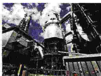
Il termovalorizzatore di Acerra
